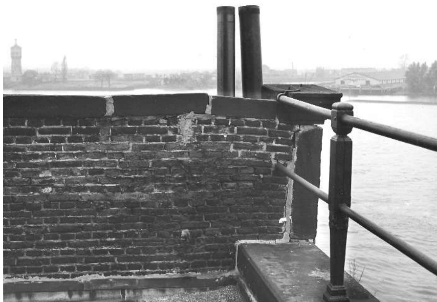
13.6 De bouwtechnische staat op het terras bij de balustrade was evenmin rooskleurig te noemen.
