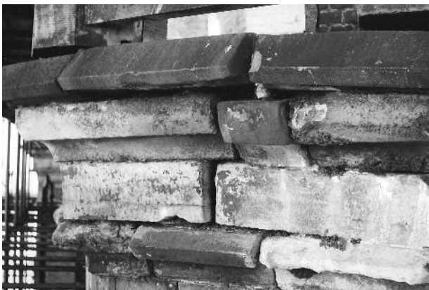
4.2 Van de balustrade op de omloop hadden de natuurstenen onderdelen vrijwel alle samenhang verloren.
