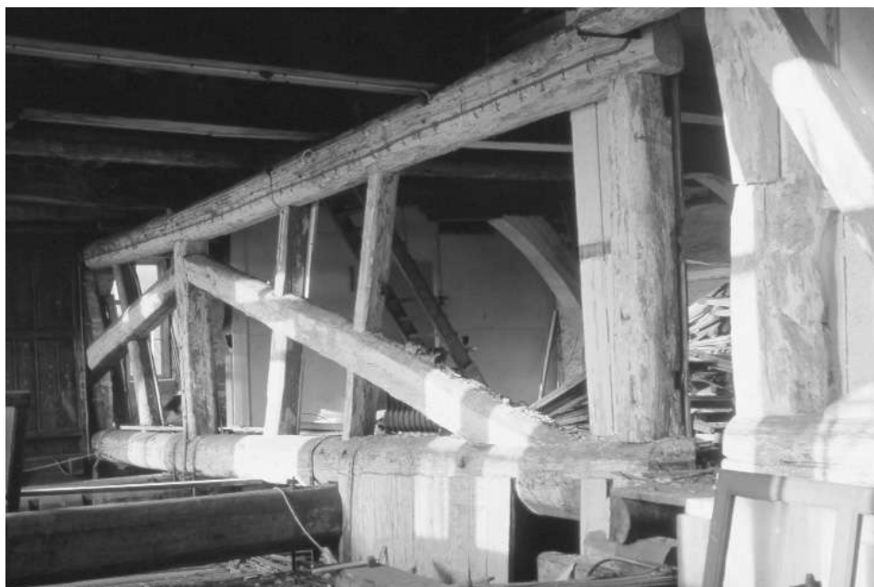
16.7 De aangetroffen noodverbanden op de eerste verdiepingsvloer, een gevolg van de ingrepen door architect Itz in de 19e eeuw.
