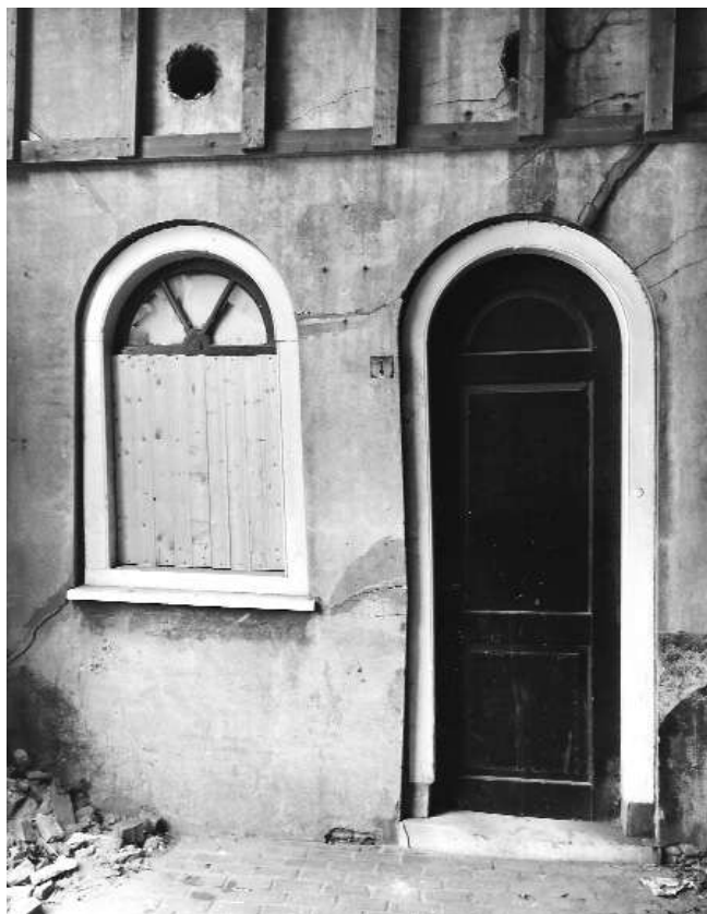
13.5 Vervormingen in het metselwerk van de binnenpoort.
