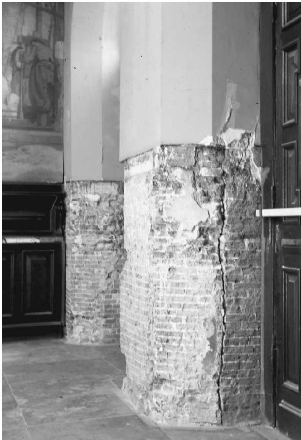
18.1 Na verwijdering van de lambrisering bleek dat het dragende metselwerk rechts van de middeningang duidelijk ontzet was. Dit werd veroorzaakt door de daar optredende hoge bovenbelasting.
